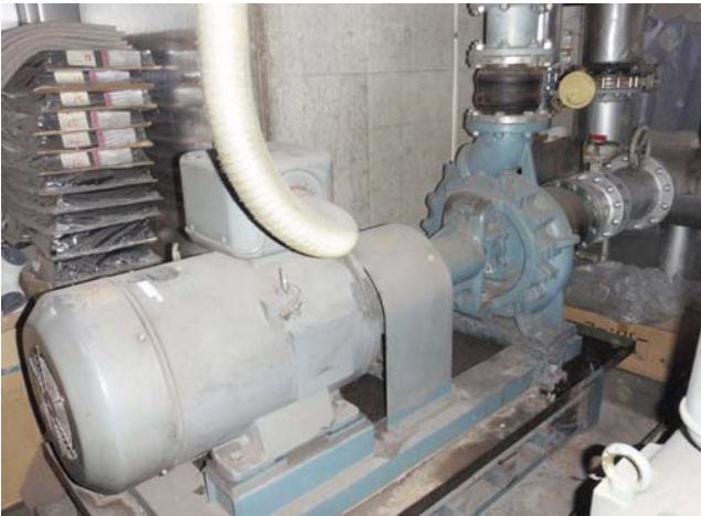
ポンプ 更新前
