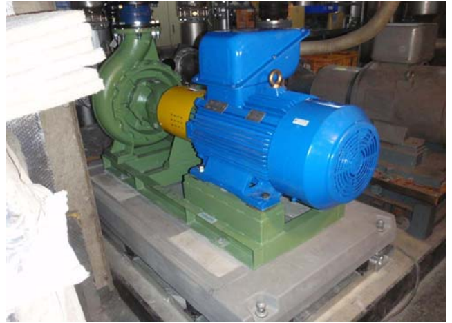
ポンプ 更新後
