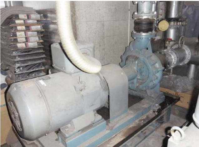
ポンプ 更新前
